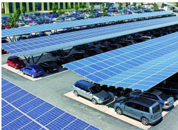
Рис.1. Автостоянка с навесами с солнечными модулями [2].
